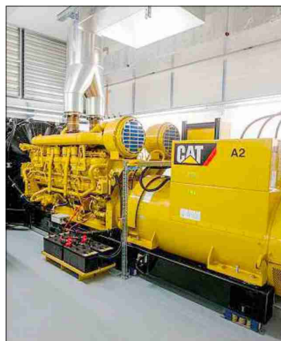
Einer der Dieselnotstromgeneratoren Bild: zVg
