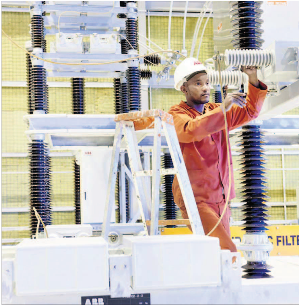
Hightech mitten in Afrika: Der Schweizer Großkonzern ABB hat in Gerus eine Gleichstromnetz-Anlage errichtet. Die Technik wird die Stromversorgung in den kommenden Jahrzehnten revolutionieren. Das Bild zeigt einen Mitarbeiter in Namibia. Foto: ABB/oh
