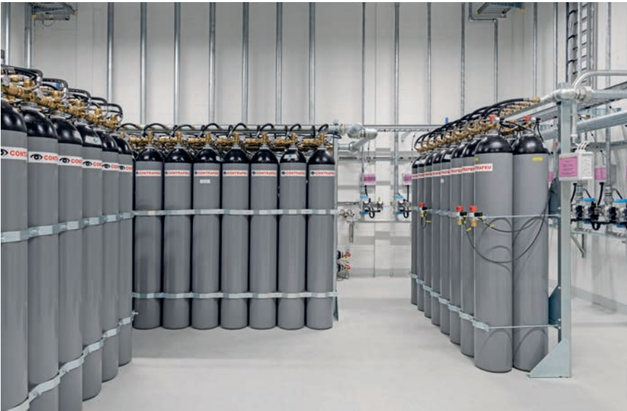
Um den höchsten Ansprüchen an den Brandschutz gerecht zu werden, werden die Räumlichkeiten im Brandfall Brandherde mit Löschgas bekämpft.
