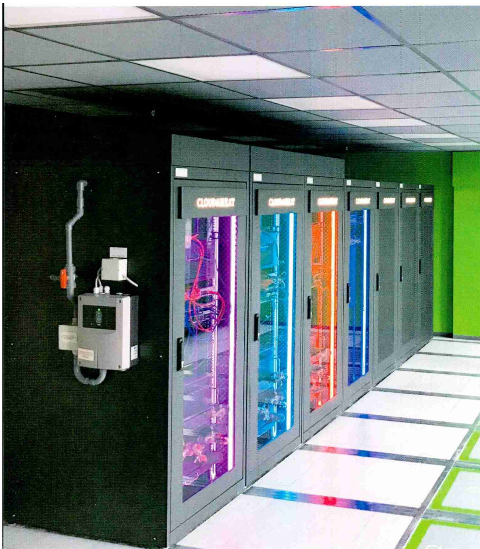
Mikro-Rechenzentren mit Abwärmenutzung von Cloud & Heat im Büro- und Hotelhochhaus Eurotheum in Frankfurt am Main. Foto: Cloud & Heat, Dresden
